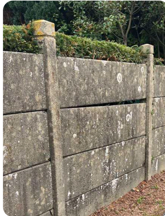
Clôture en mauvais état sur \pm 85\text{m}
